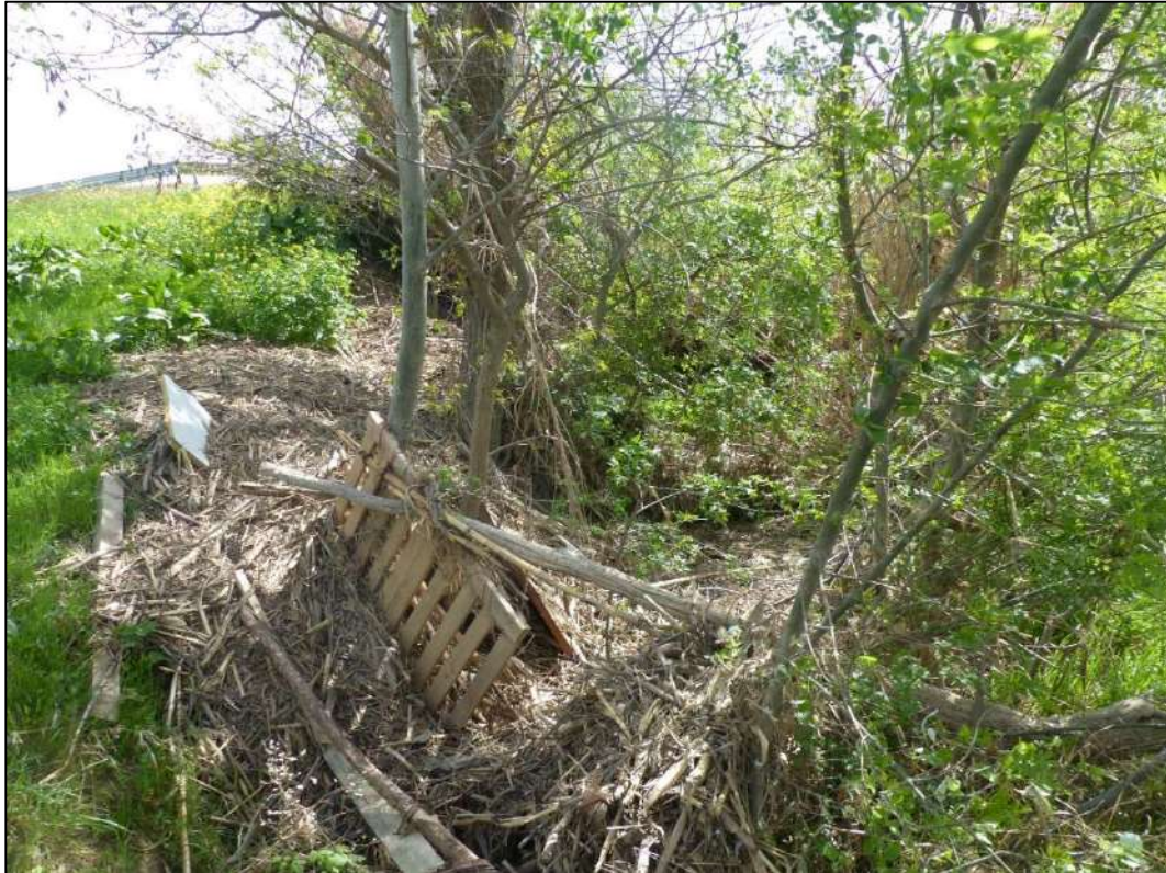
Figura 45. Imagen del punto bajo la carretera NA-115 en el tramo Peralta-Funes, por los que el agua debería cruzar bajo la carretera a través de las canalizaciones de drenaje existentes que sin embargo se encuentran taponadas artificialmente.
