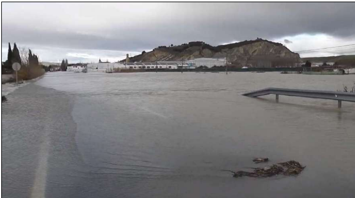
Figura 27 Fotografía de la carretera NA-128 cortada por inundación durante la riada de diciembre de 2021. Se trata de la carretera que comunica con Peralta y con la autopista A-68.
